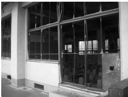
窓ガラスが熱風で割れている。
